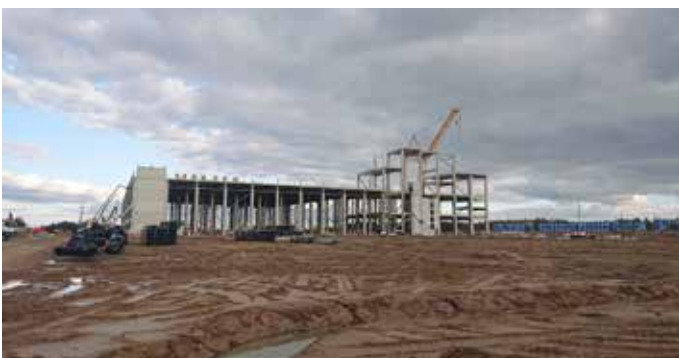
Pääprosessirakennuksen runko syyskuussa 2025. Rakennuksen laajuus on noin 140 x 140 metriä ja korkeus enimmillään noin 30 metriä. Kuva: Sweco
